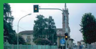
IMPIANTO SEMAFORICO DISSUASORE DI VELOCITÀ
